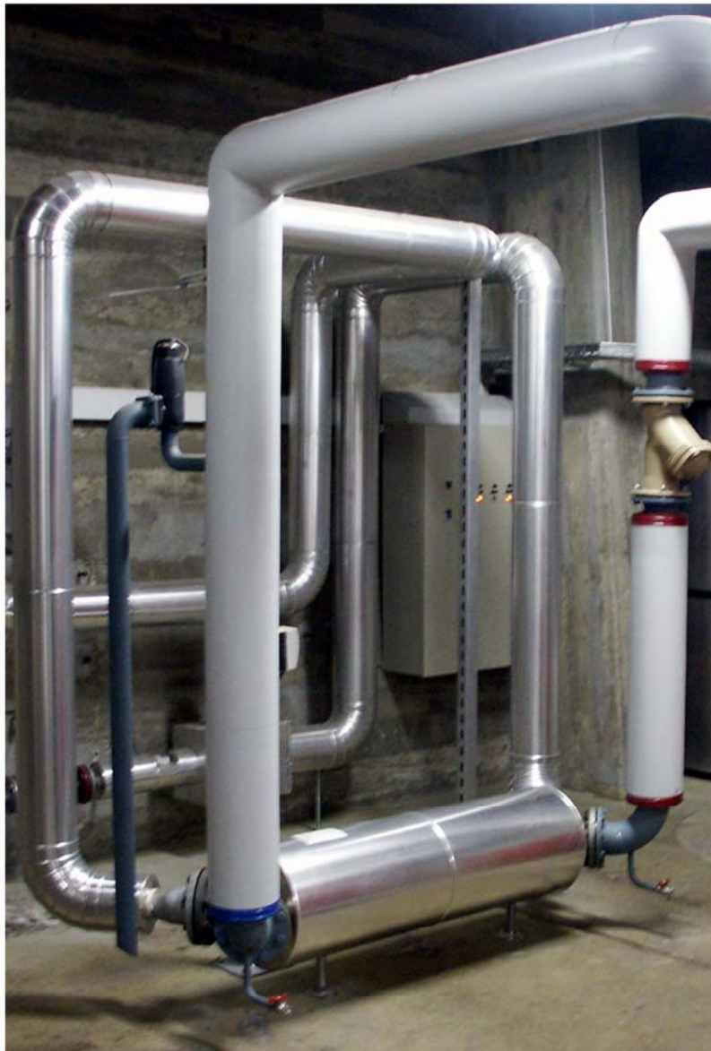
Installation en position horizontale Installateur: Brauchli SA. Lausanne
